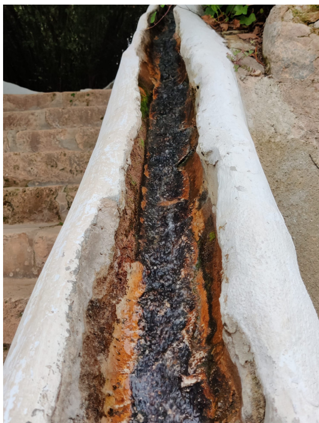
Detalle del pasamanos de la escalera con el agua corriendo por ella
